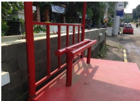
Gambar 8. Kondisi Sisi-sisi Shelter BRT Koridor VI GSG Unnes, Sumber: hasil survei, (2017)
